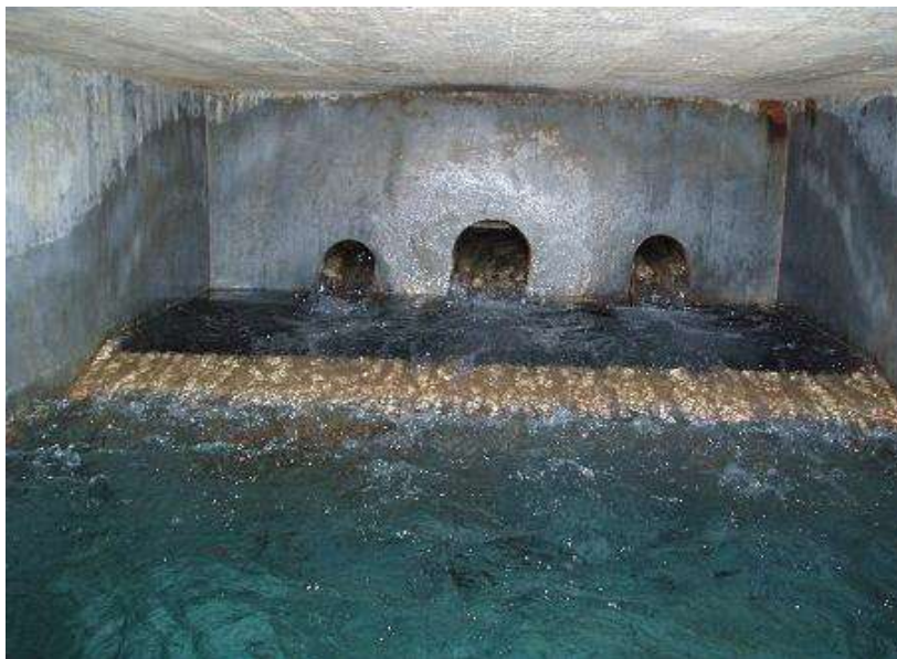
Sabirna komora s dovodnim drenovima u kaptaži Bistrica
